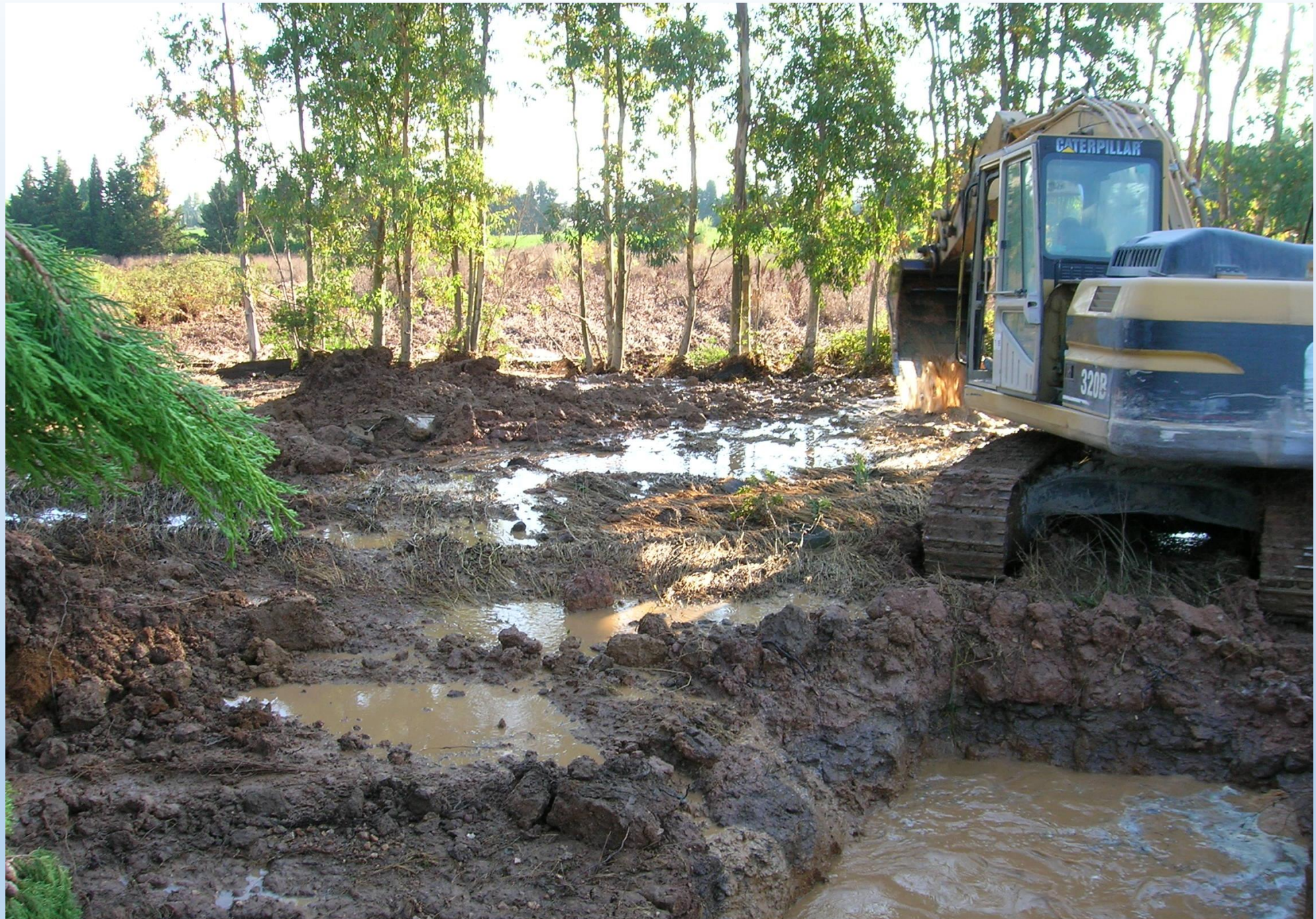
ALLAGAMENTO AREE PRIVATE A CAUSA DELLA ROTTURA DELLA CONDOTTA DN 2.000 MM
