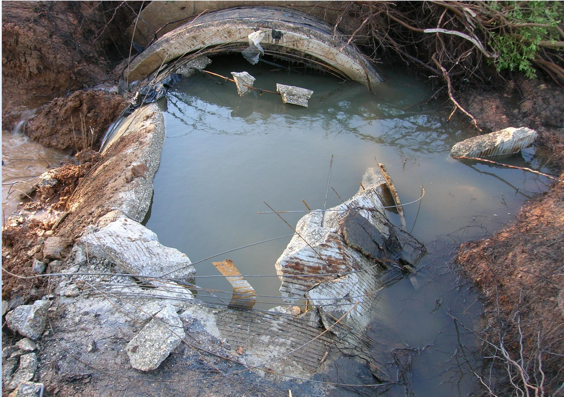
ROTTURA DELLA CONDOTTA
