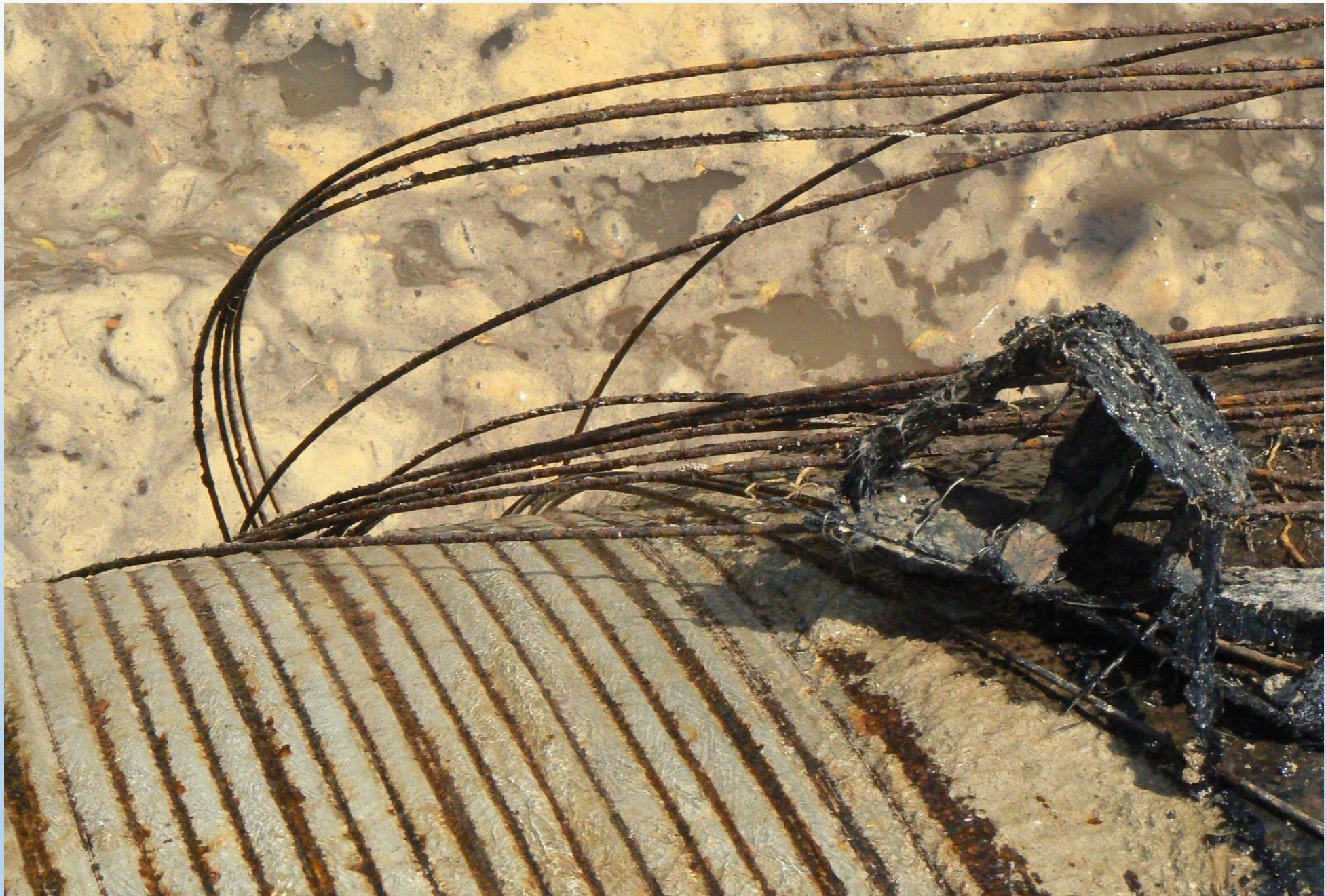
DETTAGLIO DELLA ROTTURA DELLE SPIRE IN ACCIAIO IN CORRISPONDENZA DEI GIUNTI
