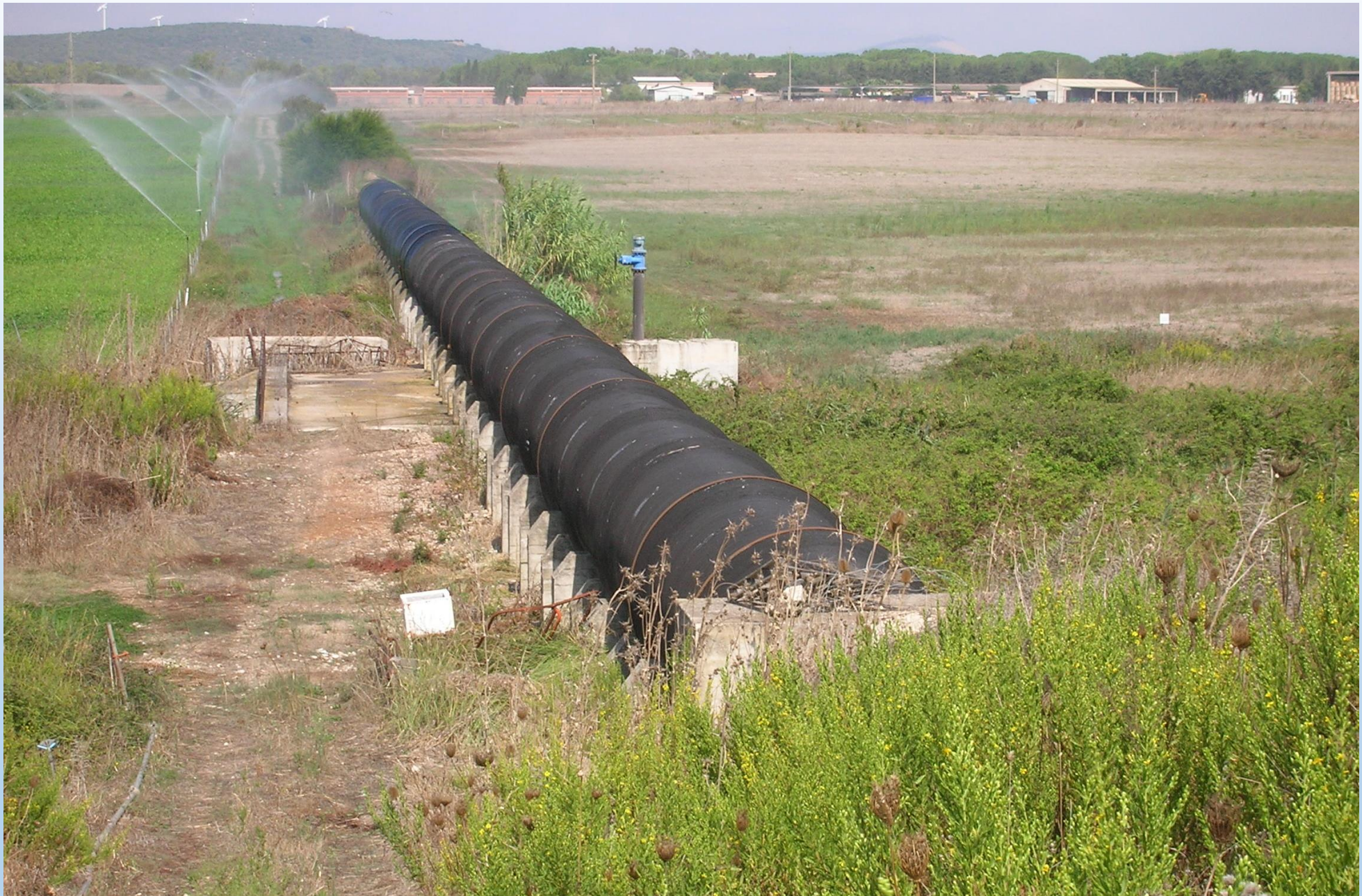
CONDOTTA ADDUTTRICE NORD IN C.A.P. DN 2.000 MM TRATTO SU SELLE DI APPOGGIO
