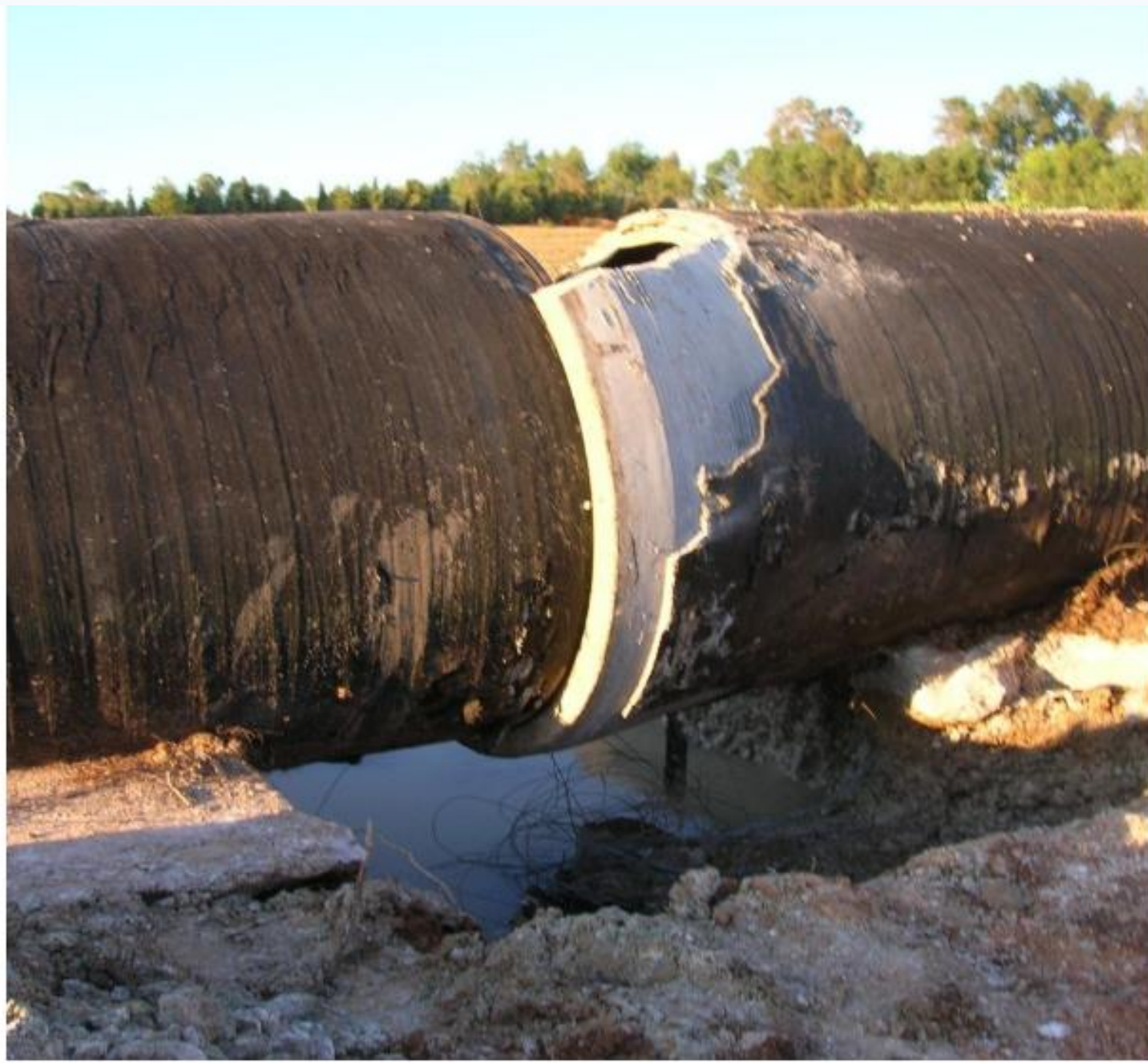
ROTTURA TIPICA DELLA TUBAZIONE IN CLS: COLLASSO IN PROSSIMITA' DEL BICCHIERE
