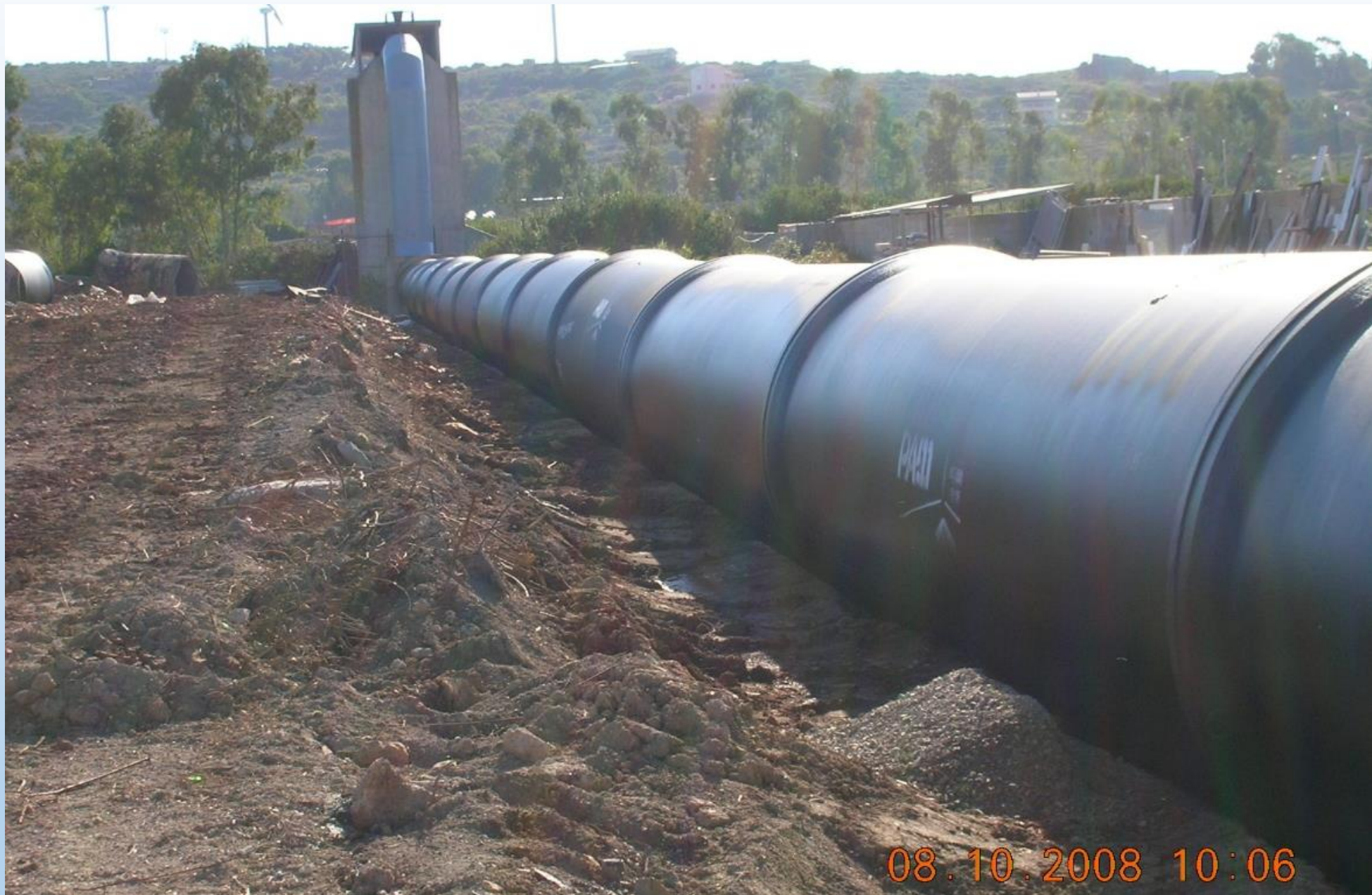
TRATTO DI CONDOTTA PARZIALMENTE INTERRATA CON TUBI IN GHISA SFEROIDALE
